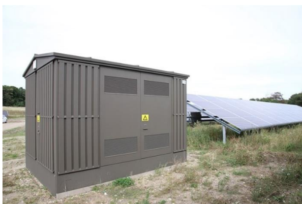
Foto: Eksempel på teknikbygning. Her en typisk fordelingstransformer placeret i en såkaldt transformerkiosk. Der etableres ca. en fordelingstransformer per 3-4 MW installeret solcellekapacitet.
